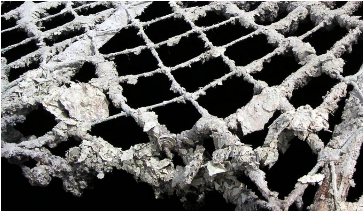
Abb. 3: Schwefelkristalle am Netz im Fermenterdach. Die Maschenweite des Netzes beträgt etwa 8 cm
